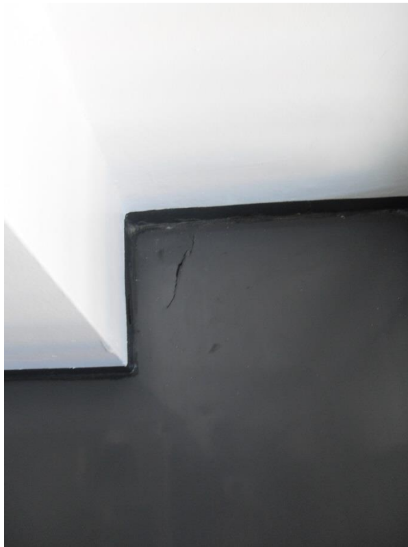
Bild 13: Schaden Nr. 28: Riss im Boden (Badezimmer)
