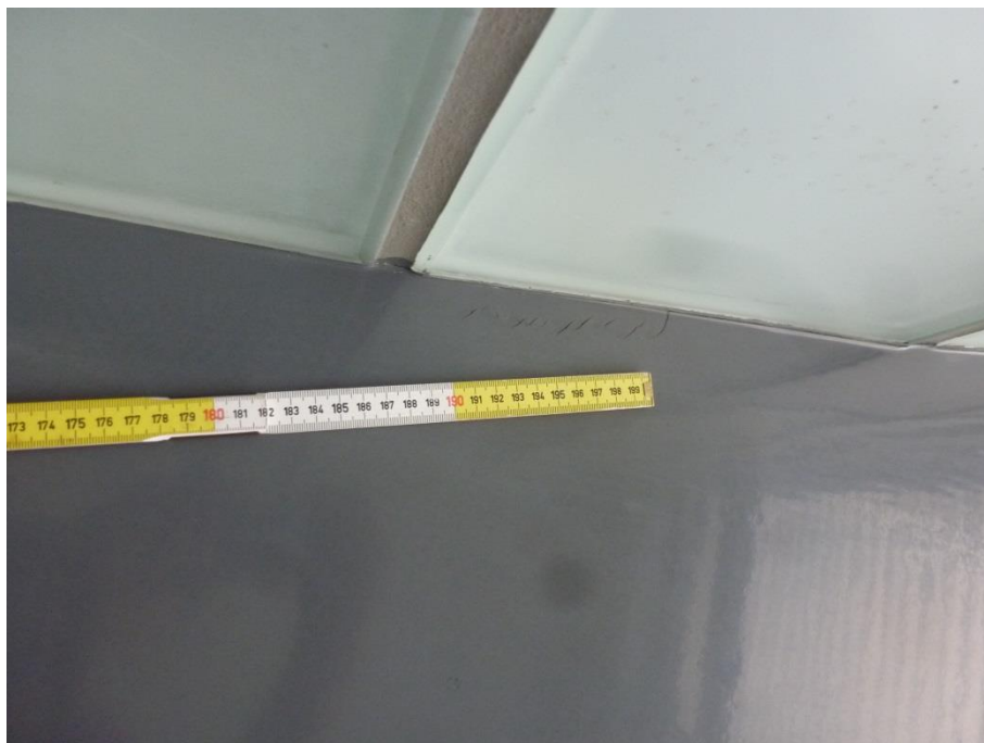
Bild 10: Schaden Nr. 11.b: Schrumpfriss im Boden an der Glaswand
