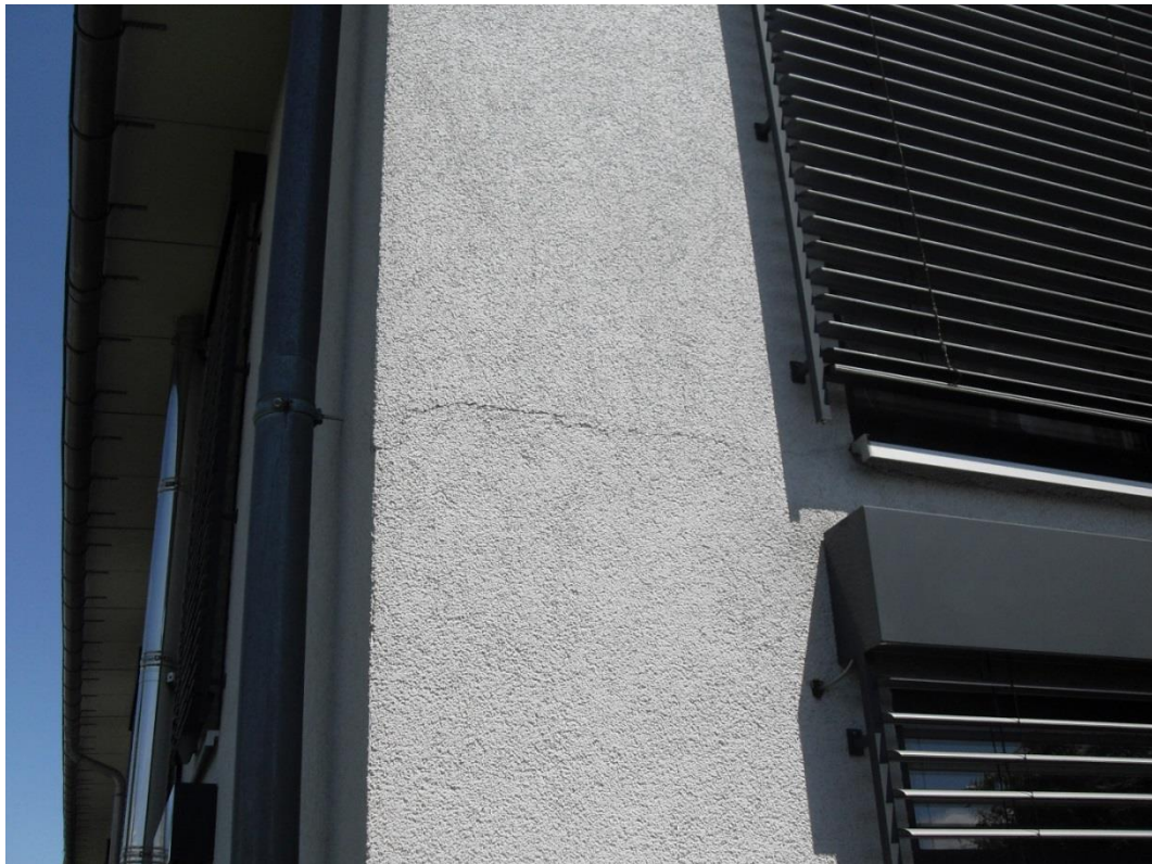
Bild 65: Schaden Nr.1 :Risse in der Ecke infolge Zugkräfte
