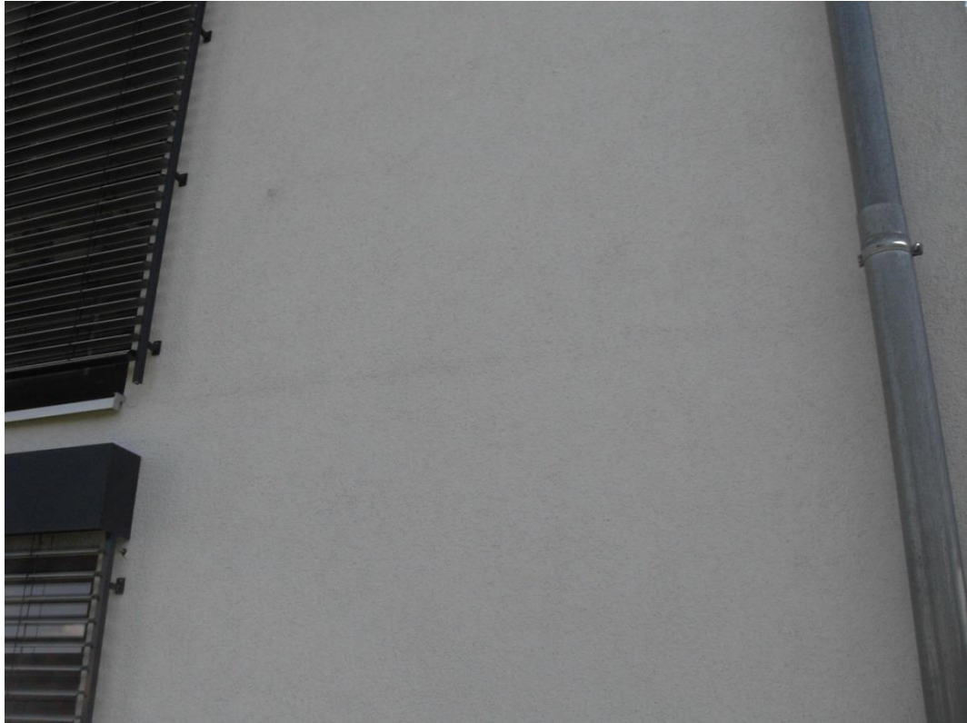
Bild 66: Schaden Nr.1 : Risse in der Wand infolge Zugkräfte
