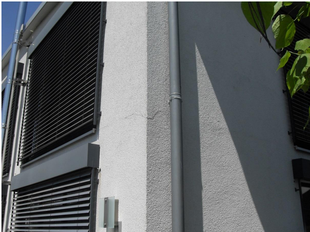
Bild 67: Schaden Nr.7 : Risse in der Ecke infolge Zugkräfte
