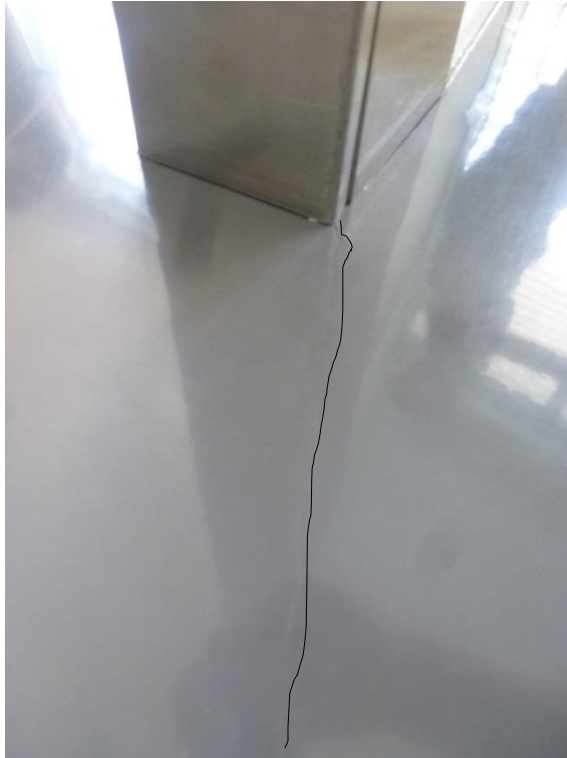
Bild 9: Schaden Nr. 11.a: Schrumpfriss im Boden – Estrich von der tragenden Stütze an der Glaswand ausgehend
