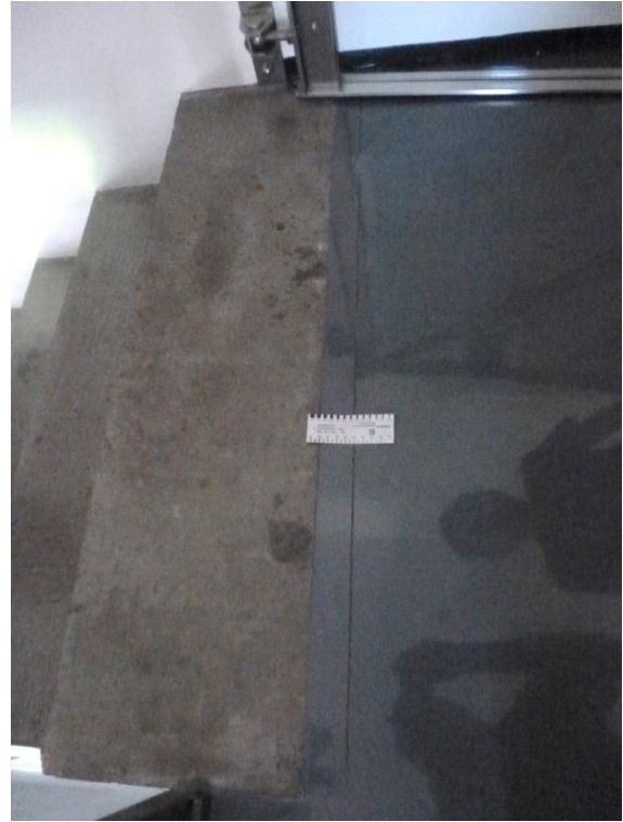
Bild 15: Schaden Nr.14: Detailaufnahme
